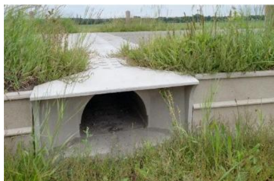
Amfibieëntunnel. Bron: Arfman Hekwerk BV
