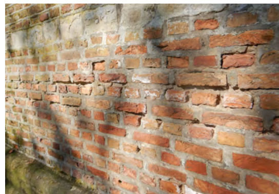
Slecht uitgevoerd voegwerk met vervolgschade
