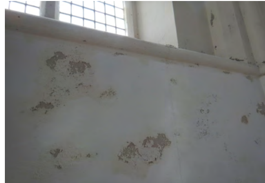
Schade aan pleisterwerk
