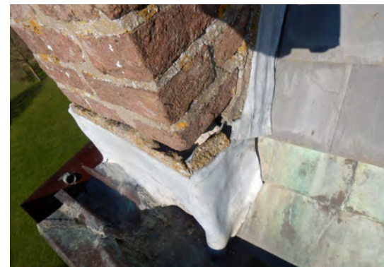
Loskomend muurlood met lekkage als gevolg
